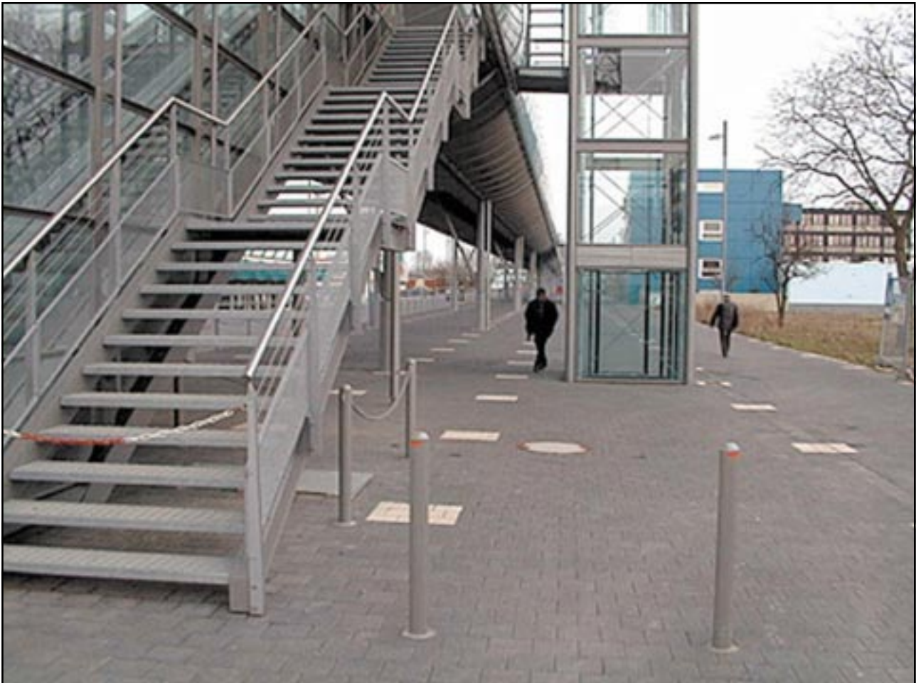
Treppe mit nicht zulässigen offenen, unterschrittenen Stufen.
